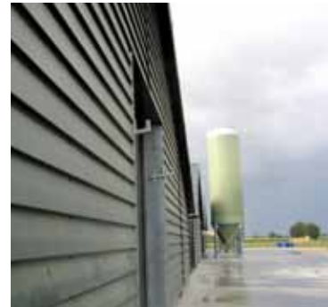
Bijna 120 meter gevel geven het bedrijf van Hans van Bommel een markant beeld
