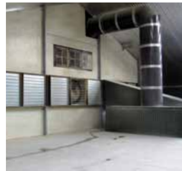
Een warmtewisselaar verlaagt de ammoniakuitstoot en levert de nodige energiebesparing op
